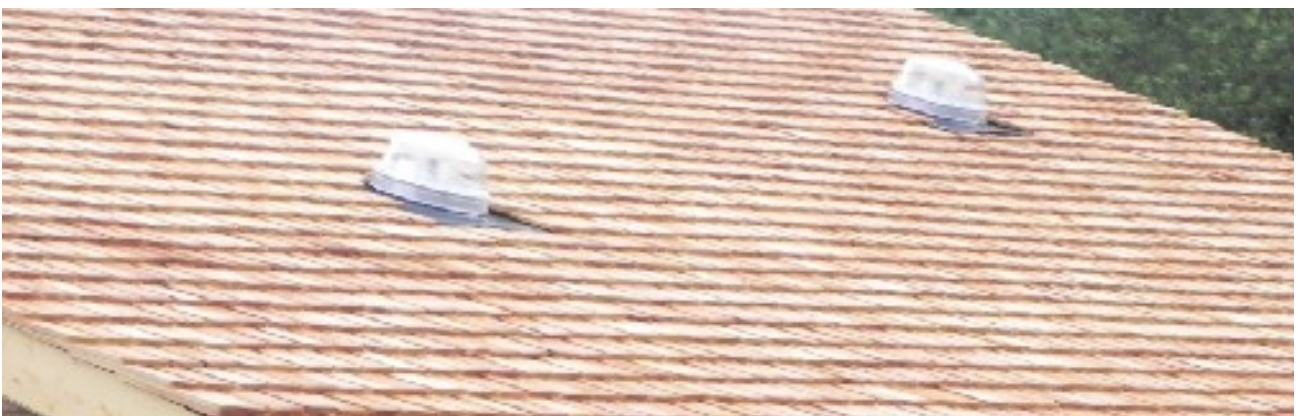
Photo N° 13. Les puits de lumière éclairent les zones de travail et les parties communes. (Solarspot/LFR)
