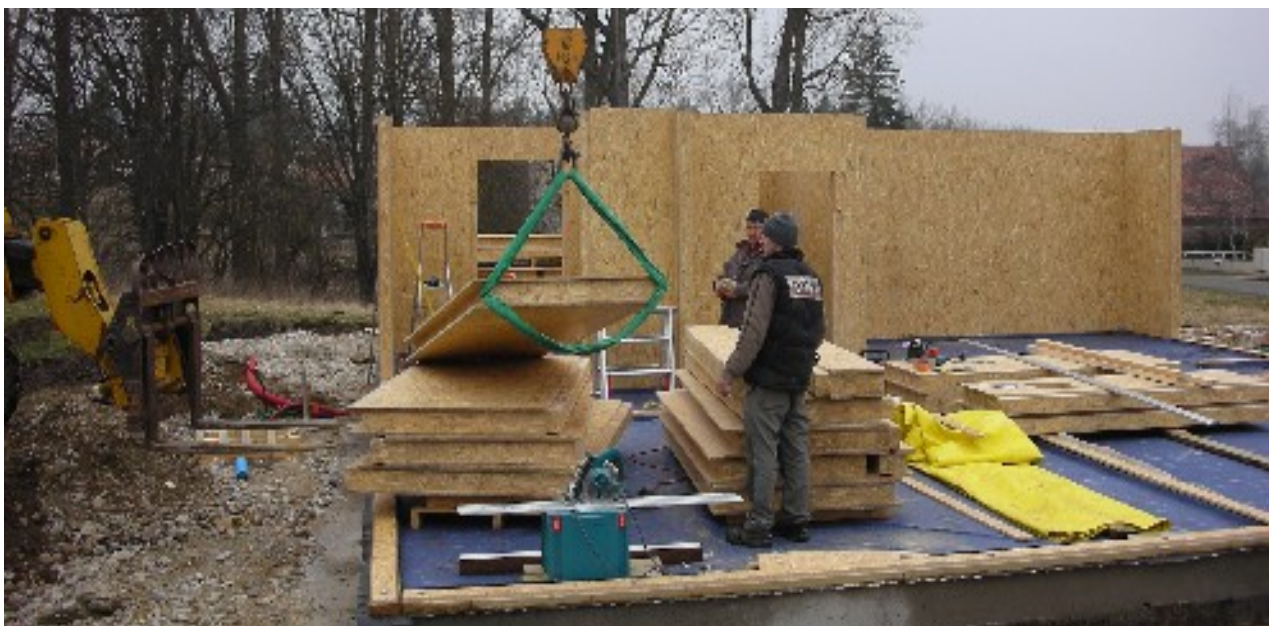
Photo N°2. Un coffre de mur extérieur est en cours de pose. Il a été apporté ici à la grue ; ce genre de coffre peut être mis en place à deux hommes, sans moyen de levage, si l'on pratique « l'auto-construction ». Remarquer les lisses au sol. A 850 m d'altitude, toute la construction a été réalisée en hiver.
